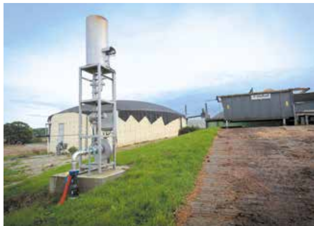
La torche est mise en fonctionnement pour des raisons de sécurité lorsqu'il faut détruire le biogaz.
