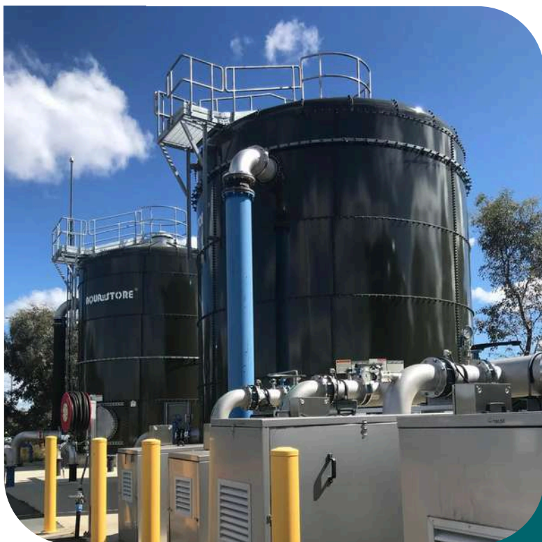
Figure 3. Réservoirs de stockage d'eau recyclée.
