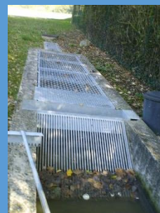
Dégrilleur – Step Angles sur Anglin
