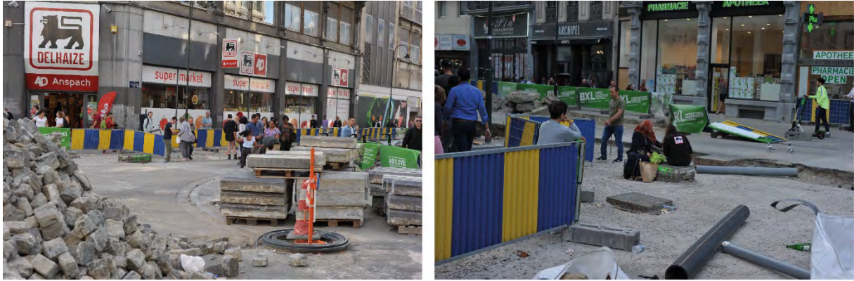
Fig.25 : Ouverture illicite des périmètres des travaux.
