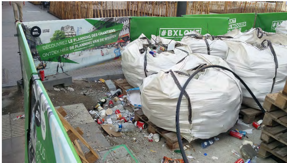
Fig.23 : Travaux utilisés comme benne à ordures.
