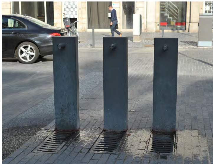
Fig.32 : Fontaine à eau potable du piétonnier.
